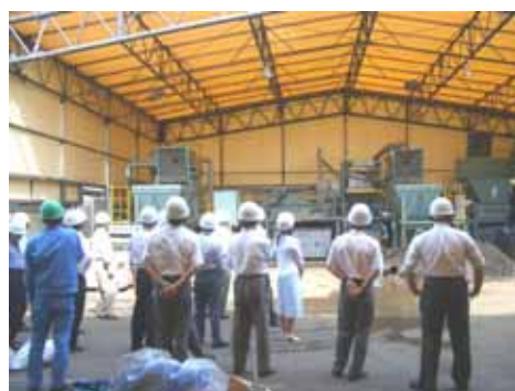
二軸破碎機と混合ゴミ選別機
